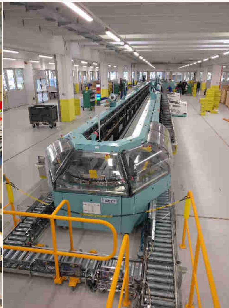
Sistema XMS-2 di SOLYSTIC, smistatrice con AGV ("shuttle") per lo svuotamento e sostituzione dei cassette codificati, CMP di Catania, 2020
